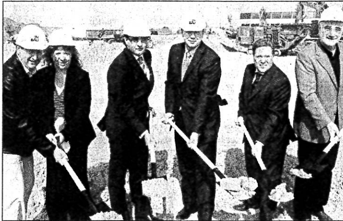
Frisch ans Werk: von links Günter Rudolph, Annette Arensman, Kais Zahel Zei (alle Pro Logis), Kai Trampedach (PR Bau und Boden), Claus Wichmann (Pro Logis) und Bürgermeister Karl-Heinz Färber beim Spatenstich im September.
